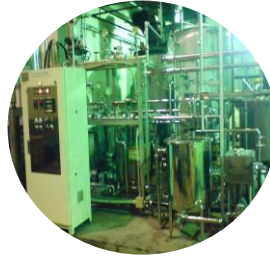
殺菌装置設備（施工例）
